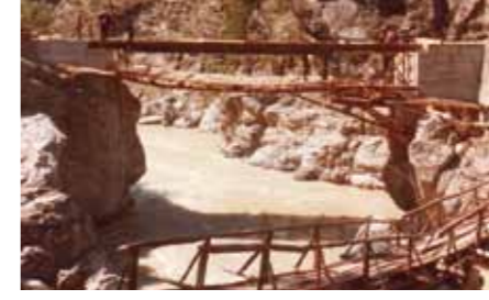
Yeni Dalaman Köprüsü yapımı. Yandan görünüş. Eski köprüünün yıkılmış ayağı üzerine yapılmış olan geçici yaya köprüsü önde görülüyor.
