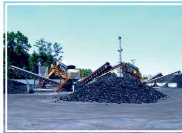
KÖMÜR ELEME ve SINIFLANDIRMA TESİSLERİ
