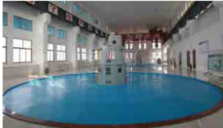
Resim 13: Doğu projesi pompa istasyonu
